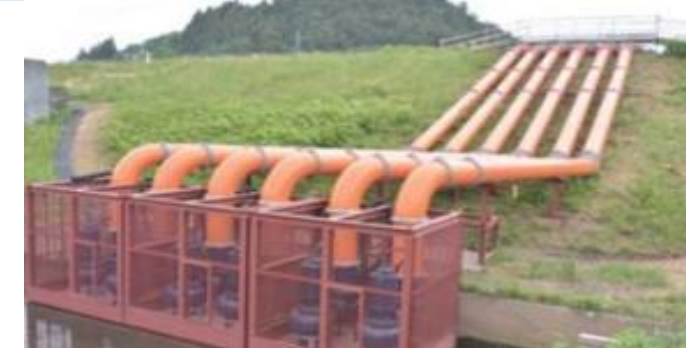
仮設の排水ポンプ (給食センター裏)
