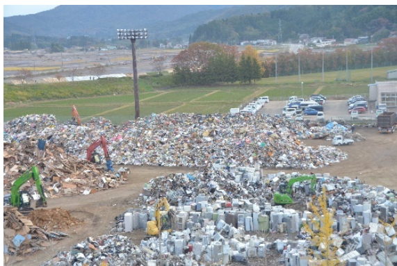
災害廃棄物仮置き場の様子（丸森町町民広場）
