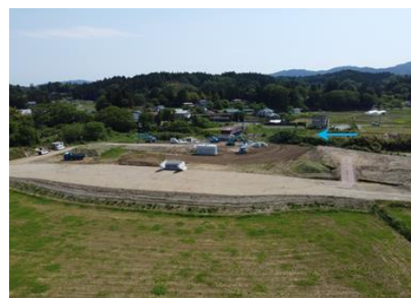
中平橋上部工工事・中平橋取付道路工事の様子(大内字中平)
