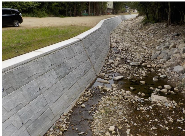
黒佐野川(大内字南平)復旧後の様子
