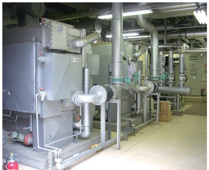
更新が計画されている空調用ボイラー
