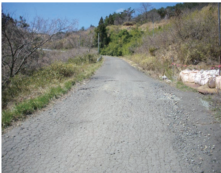
土砂運搬で壊れた道路（石倉線）
