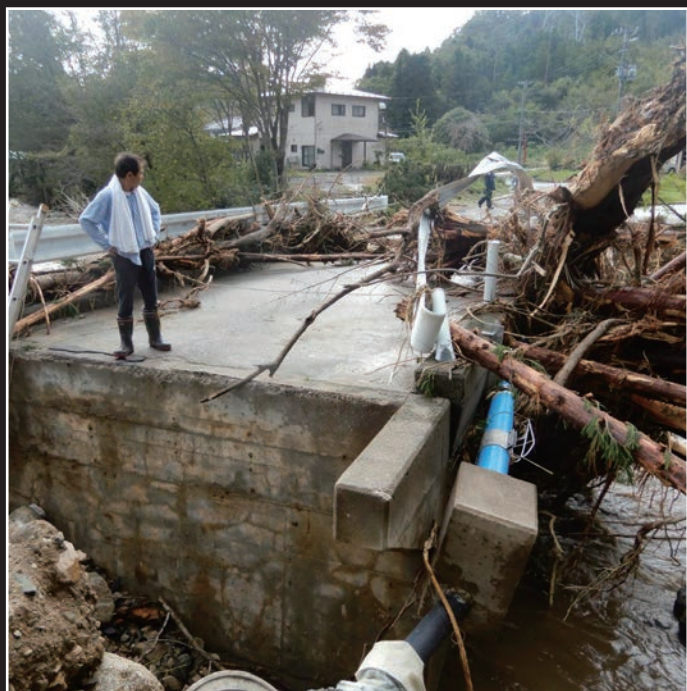
濁流で破壊された橋（大内地区）
