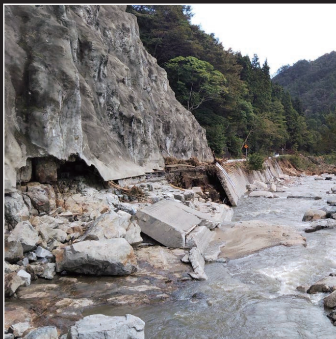
崩落した川沿いの県道（筆甫地区）
