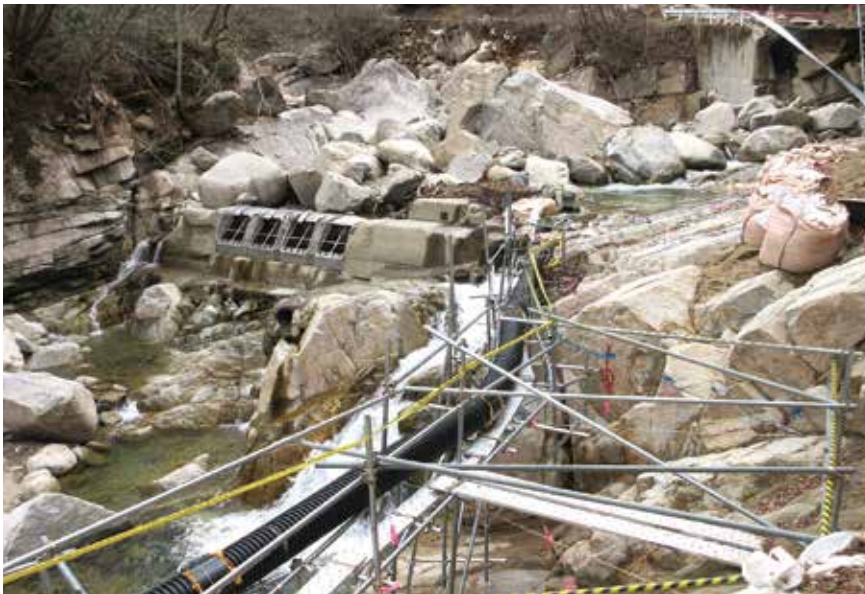
仮復旧が完了した石羽浄水場の取水口（筆甫鷲ノ平地区）
