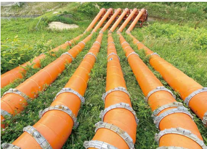
仮設ポンプの設置で排水能力を確保
