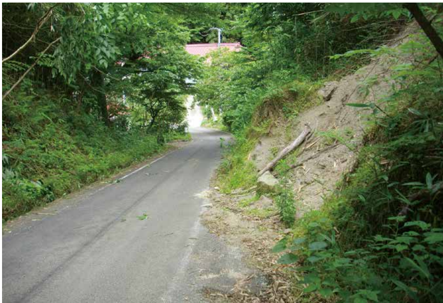
側溝が土砂で埋まったままの町道（耕野地区）
