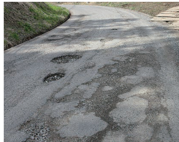
災害復旧車両によって破損した道路（筆甫地区）
