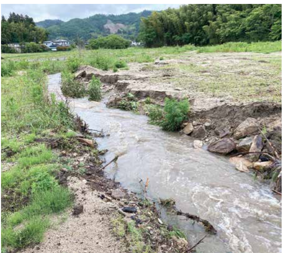
令和4年6月の大雨で再び被害を受けた河川(五福谷地区)
