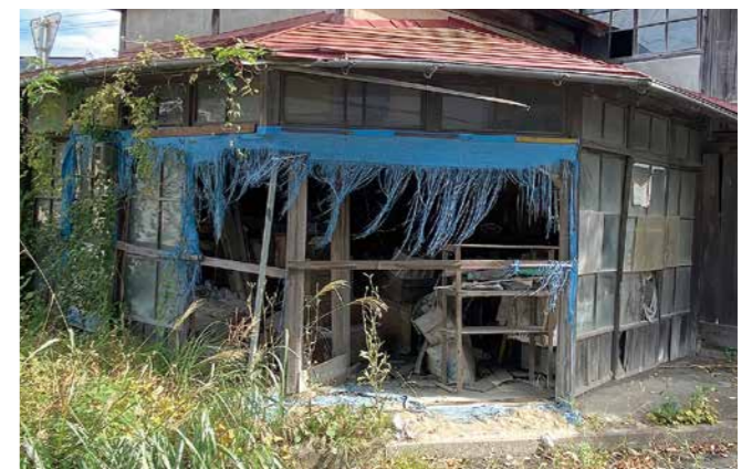
40年以上放置されたままの危険空き家（中心市街地）
