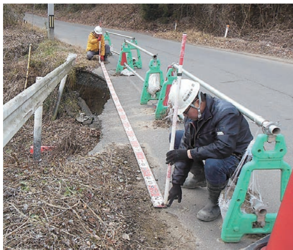
復旧作業を開始した路肩の被害(町道五福谷金ヶ作線)
