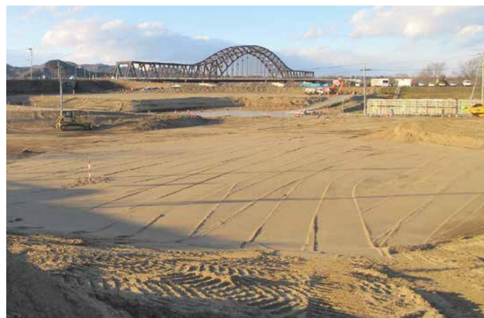
町の防災拠点や賑わいの場として活用される防ステ造成工事
