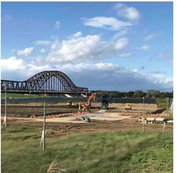
令和7年度の完成を目指して工事が始まった防災ステーション建設現場
