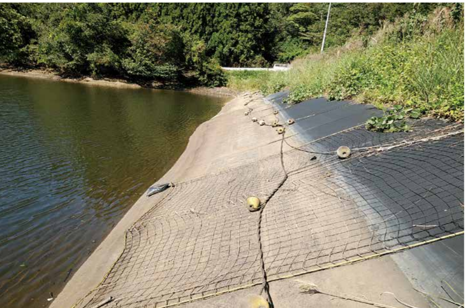
安全対策として設置された救助ネット (大内地区)
