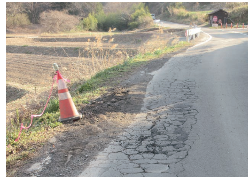
大型車両の往来によって損傷した道路 早期の改修を望む (県道丸森霊山線)
