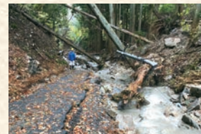
土砂災害: 町道(筆甫地区)
